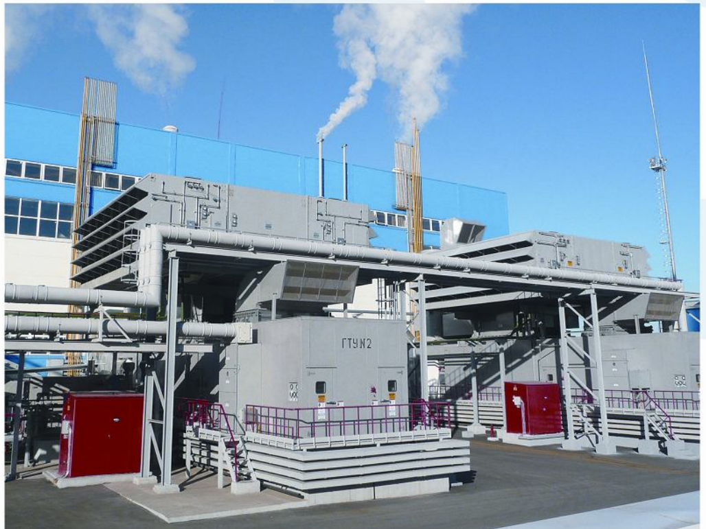
2 КУП-75-3,9-440 (75 т/ч пара) за 2 ГТУ General Electric LM6000 PD Sprint (45 МВт), ПГУ-115 МВт на Воронежской ТЭЦ-2, г. Воронеж, РФ
